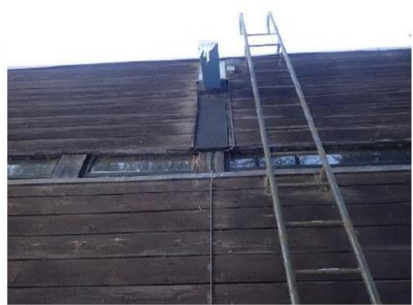
Kuva 8. Räystäskourun liitokset ovat vuotaneet ja kouru on kastellut alapuolisia rakenteita.
