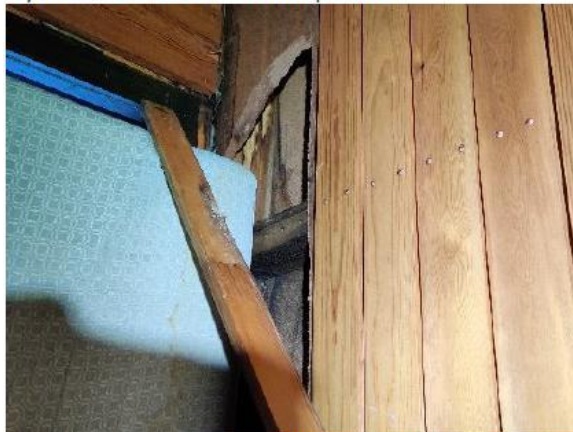
Kuva 9. Sadevesikourun kastelemaa väliseinää rakennuksen sisältä kuvattuna. Väliseinässä on kosteus- ja mikrobivaurioita.
