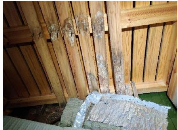
Kuva 10. Purettua yläpohjan rakennusmateriaalia sadevesikourun vuotoalueen ympäristöstä. Puretuissa materiaaleissa esiintyy kosteus- ja mikrobivaurioita, kattopaneeleissa mm. lahottajasientä.
